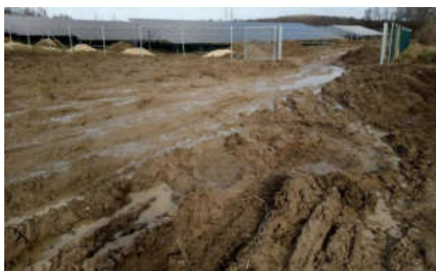
Foto 1-3: Befahrung ungeschützten Oberbodens bei ungeeigneter Witterung/Bodenfeuchte führt zu Schädigung des Bodengefüges und schränkt die Funktionsfähigkeit des Bodens ein
